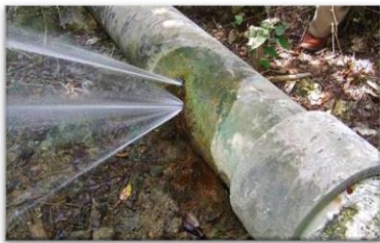
Figura 29. Fuga de agua. Por el sol de San Luis.
